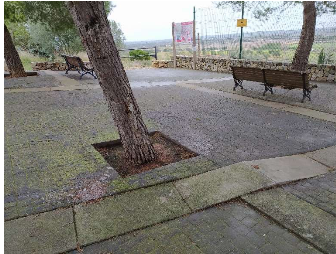
Problemas pavimento actual
